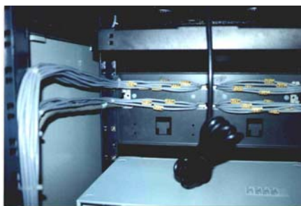
Figura 16 – Organização traseira dos cabos (no caso, temos um bloco de fiação, mas neste ponto a montagem é análoga).
