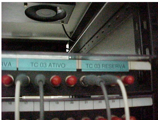
Figura 18 - Dois DIO's de rack de 24 fibras com conectores ST já montados em um rack fechado (no detalhe vemos o ventilador superior, a identificação das portas, além de dois cordões óticos duplos já fixados).
